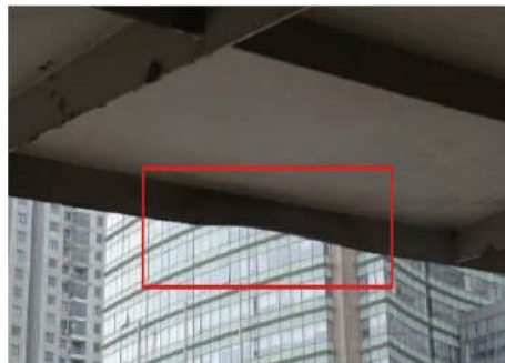
图 3 主梁翼缘侧面加劲板变形之实景
