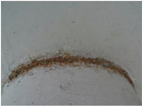
图 4 墩顶焊缝开裂之实景
