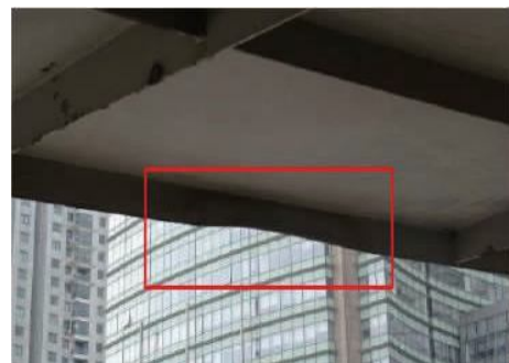
图 3 主梁翼缘侧面加劲板变形之实景
