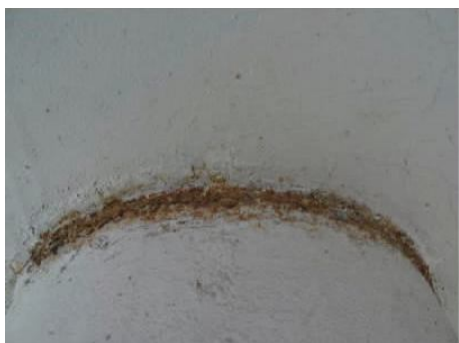
图4 墩顶焊缝开裂之实景
