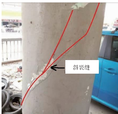
图 6 TA3-2 桥墩开裂之实景
