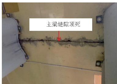
图 3 ZX159 主梁缝隙顶死之实景
