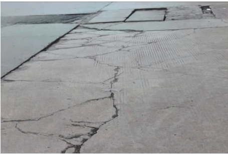
图 1 板块破碎、错台
