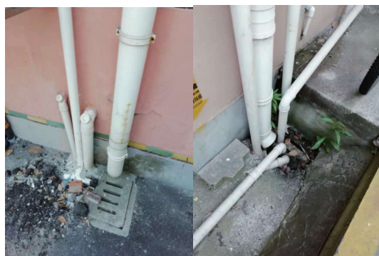
图1 私接管道现状图
