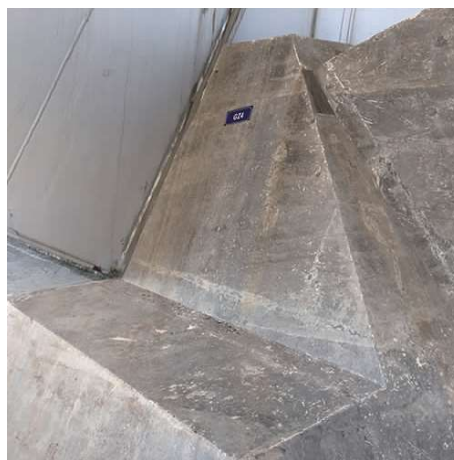
图1 拱座裸露无防护状态
