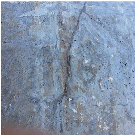
图3 表面轻微裂缝
