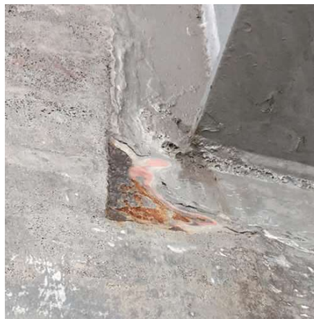
图2 表面轻微裂缝
