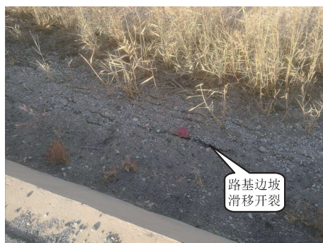
图4 路基边坡滑移之实景
