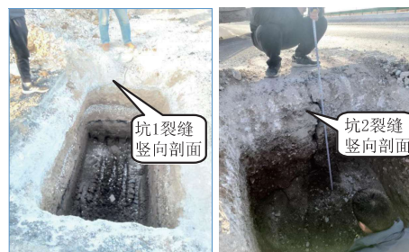
图 3 沥青路面裂缝竖向剖面之实景
