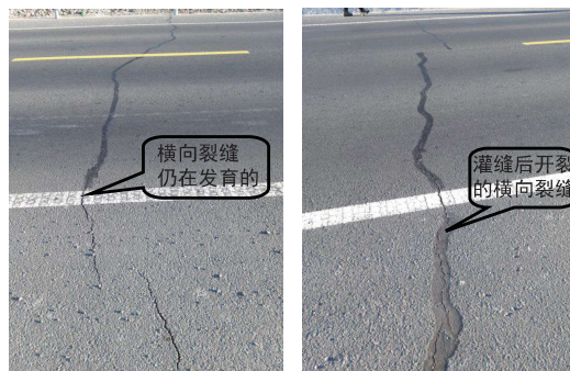
图1 沥青路面横向裂缝之实景
