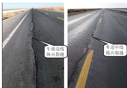
图 2 沥青路面纵向裂缝之实景
