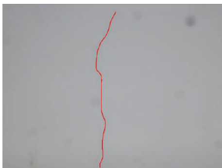
图4 左幅3#跨箱梁腹板竖向裂缝
