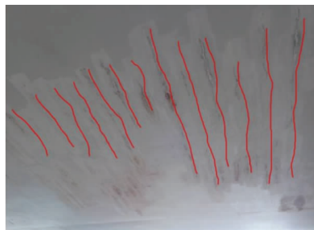
图8 左幅8#跨箱梁底板横向裂缝
