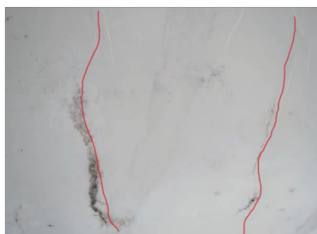
图9 左幅8#跨箱梁底板横向裂缝
