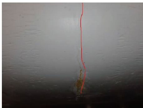
图5 左幅3#跨箱梁腹板竖向裂缝
