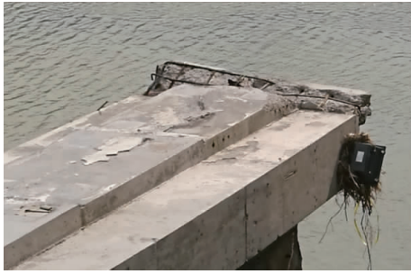
图2 桥墩挡块破坏失效
