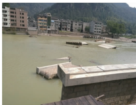
图1 水毁桥梁现场照片
