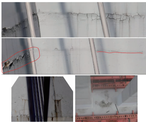
图2 索塔、墩身及承台外表面涂层劣化的病害特征
