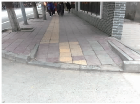
图3 盲道在坡道处断开设置
