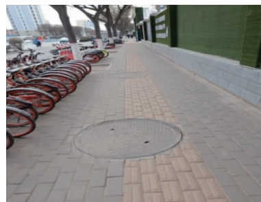
图1 盲道和井盖冲突
