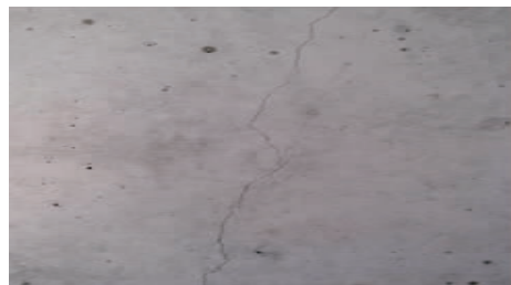
图1 地下室外墙表面裂缝情况之实景
