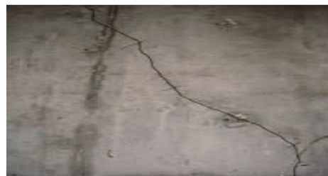
图2 地下室外墙贯穿裂缝情况之实景
