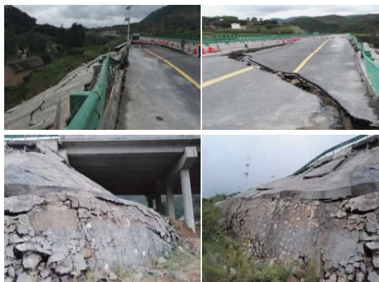
图1 路基病害现场照片
