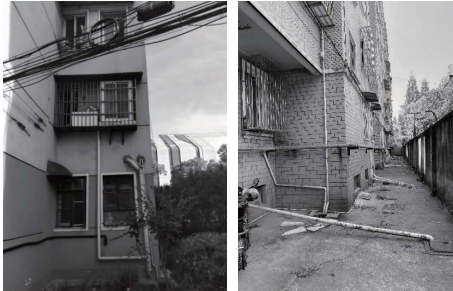
图1 建筑北侧私拉乱接废水管
