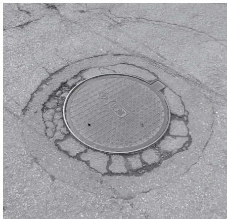
图1 机动车道检查井病害情况之实景
