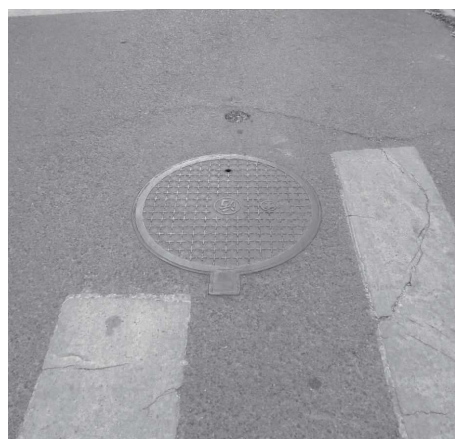
图2 非机动车道检查井病害情况之实景
