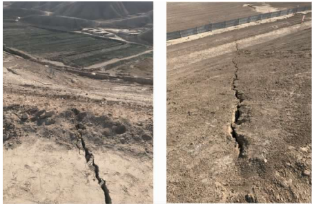
图 4 经十七路南延段路基开裂状况之实景
