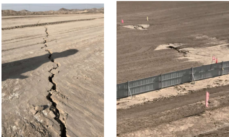
图 5 NCE8# 路路基开裂及场平陷穴之实景
