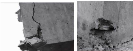
图 12 预制构件起吊损坏示意图
