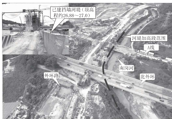
图8 南岗河河堤情况
