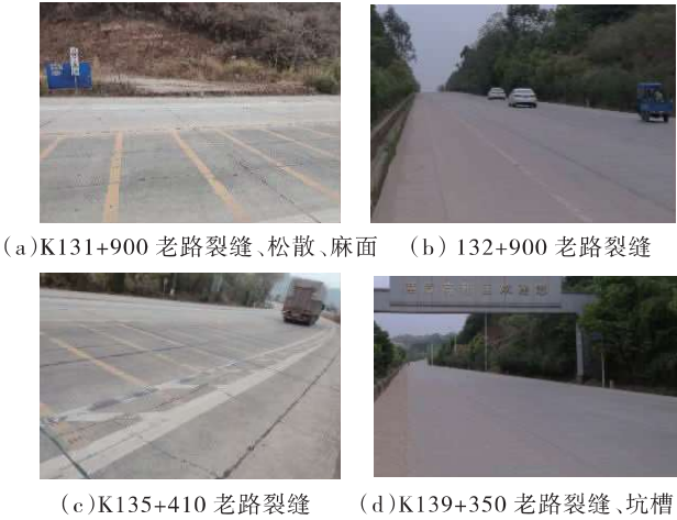
图4 混凝土路面老路现状
