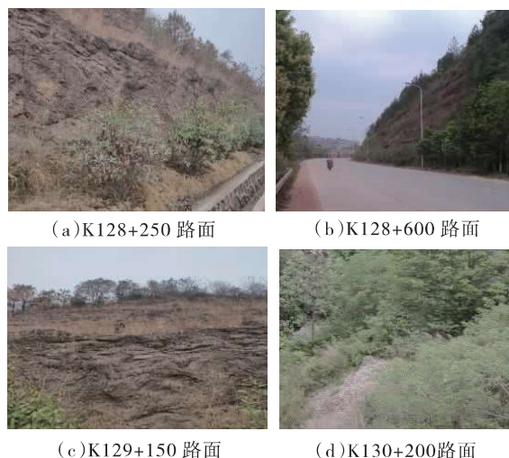
图 3 起点 K128+060 至南方万年青水泥厂 K130+500 段路面状况
