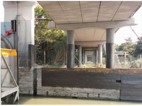
图2 遭船只擦碰的船闸桥墩
