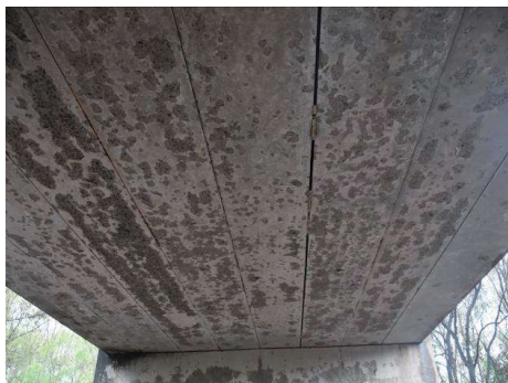
图4 第2跨梁底受火灾后情况
