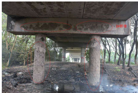
图3 2#桥墩受火灾后情况
