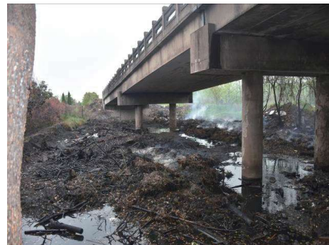
图 1 某桥火灾现场图
