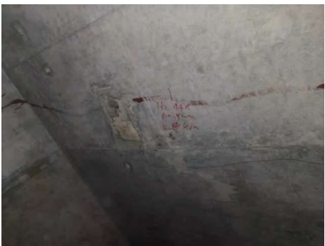
图 7 边跨顶板纵向裂缝(5号墩)
