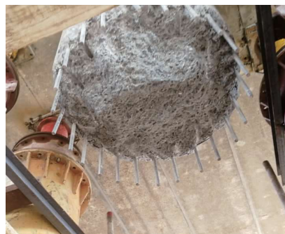
图 13 立柱凿毛露出主筋之实景
