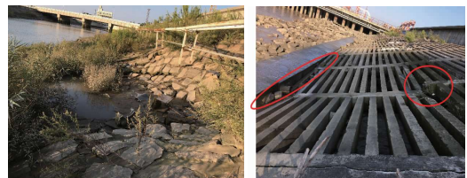
图 2 坡面塌陷, 栅栏板错断悬空等现象之实景
