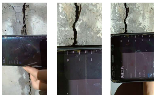
图 17 泰州路下穿通道变形缝处衍生裂缝病害图
