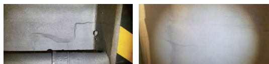
图 16 泰州路下穿通道起皮空鼓破裂病害图
