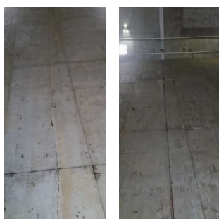
图 14 泰州路下穿通道拱顶贯穿裂缝病害图
