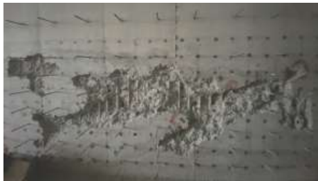
图 8 南侧墙异常区域(36~42 m)剔凿效果 本次弹性波 CT 测试与表面离析缺陷一致,经超声法检测波速异常位置高度契合,异常区域剔凿修复后经超声法复测不存在波速异常。
