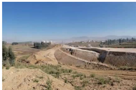
图2 路堤滑坡现场
