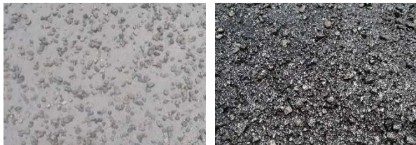
图1 浇注式沥青混合料摊铺整平后(左:正常;右:麻面)
