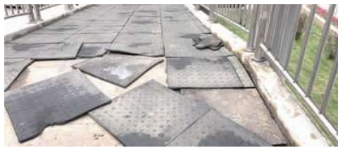
图 2 部分已损坏的盲道橡胶板铺装
