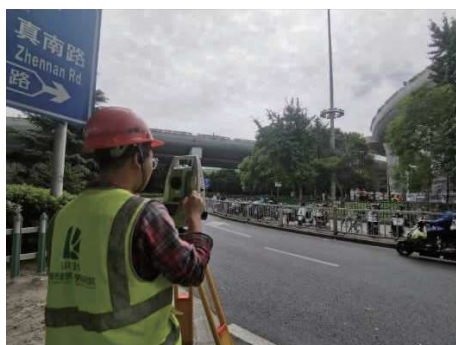
图3 灯杆整体倾斜率检测
