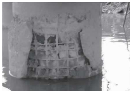
图2 左幅4-2#桩基3点钟方向典型病害
