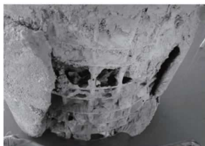
图1 左幅4-2#桩基5点钟方向典型病害
