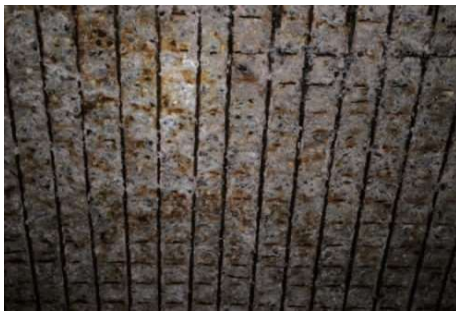
图 1 某污水厂使用二十年左右的箱涵顶板腐蚀情况之实景
