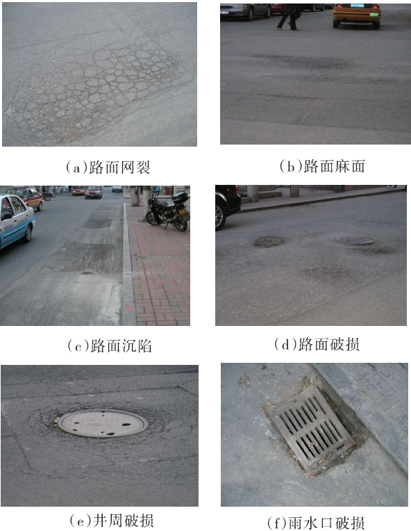
图1 现状路面病害
