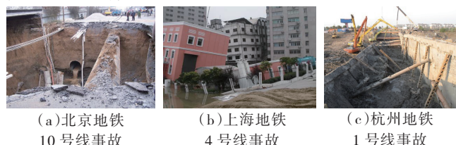
图1 地铁建设引发的安全事故
