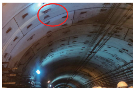
(a) 地铁隧道受损情况
