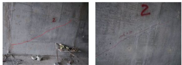
图5 腹板裂缝检测照片
