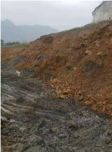
图 1 横三路含高岭土泥岩层软弱土
