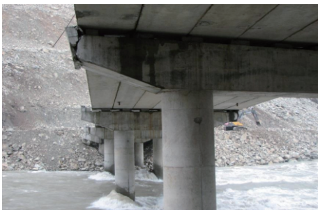
图 1 斜交桥主梁移位震害
