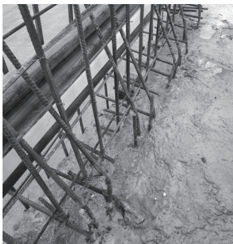
图 10 护栏迎撞面钢筋与桥面板预埋筋未按要求焊接连接
