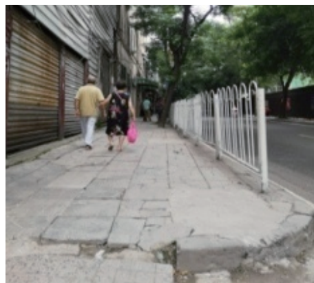
图1 人行道破损严重
