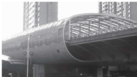
图7 长沙福元路大桥东引桥全封闭声屏障
