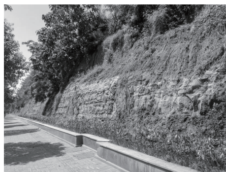
图5 植被层剥离脱落
