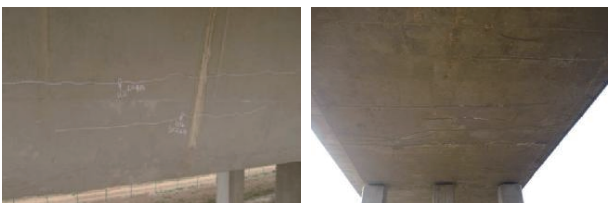
图3 腹板纵向裂缝和底板横向裂缝
