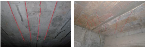
图4 顶板纵向裂缝和腹板斜向裂缝
