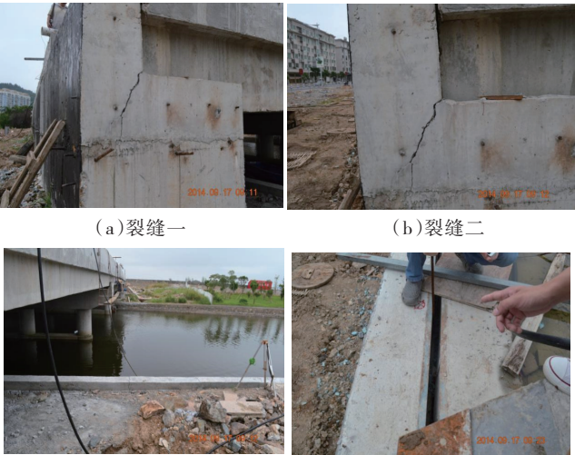
(a)裂缝一 (b)裂缝二 (c)裂缝三 (d)裂缝四
