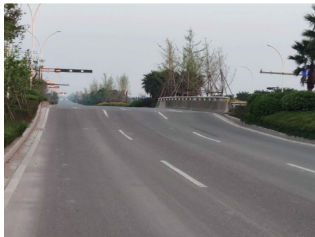
图4 半岛南路桥头竣工通车后现状(“桥头跳车”现象明显)
