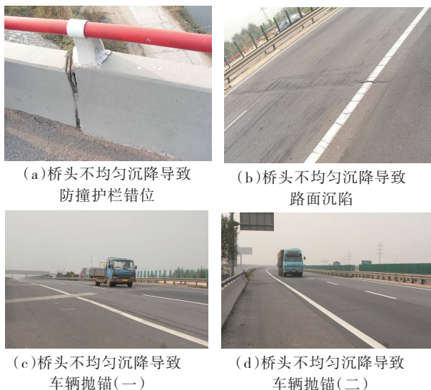
图1 桥头不均匀沉降导致的危害
