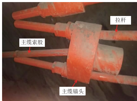
图 3 现场拉杆断裂病害及缺陷图
