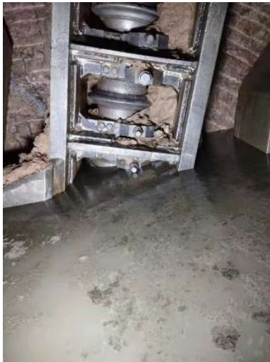
图6 开挖揭露:刀盘内开挖揭露涌水照片之实景
