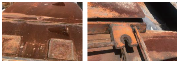
图1 钢结构锈蚀情况
