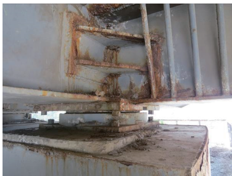
图 3 彩虹桥主桥病害图 - 支座锈蚀
