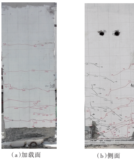
图7 墩柱裂缝分布图
