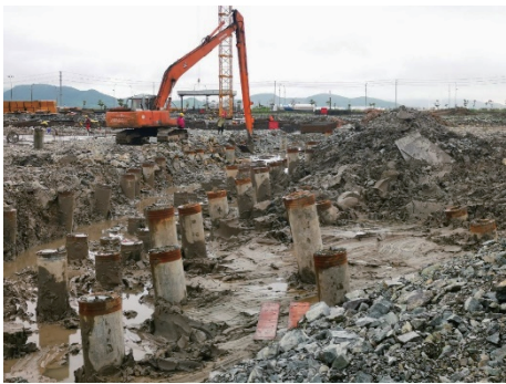
图 4 淤泥质土区域开挖桩基偏位之实景二
