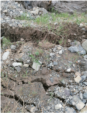
图 6 边坡土质断层之实景
