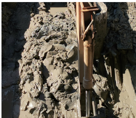
图10 淤泥质土未加固之前土方效果及工程桩偏位之实景
