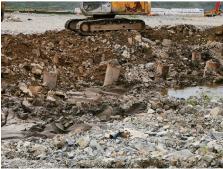
图 3 淤泥质土区域开挖桩基偏位之实景一
