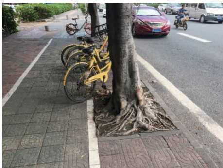
图4 道路道板砖铺装老旧
